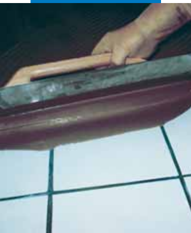
Verarbeitung von Ultraplan mittels Glättkelle auf vorhandenem Keramikbelag nach Grundierung mit Mapeprim SP
